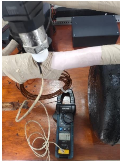
Gambar 4.21 Pengukuran Suhu Aktual Evaporator Dengan Multimeter Value VMC-1
