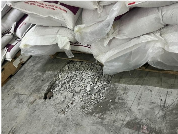
Gambar 4.7 Kondisi Lantai Gudang yang Rusak
