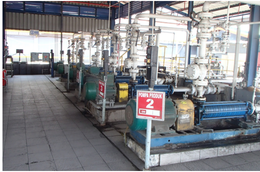
(a) Rumah Pompa
