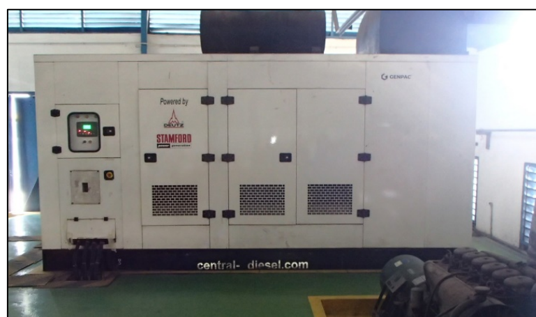
Gambar 4.2 Fasilitas Sistem Kelistrikan
