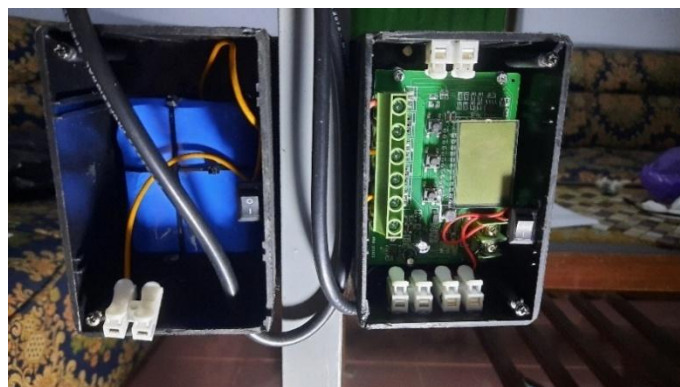
Gambar 4-4 Perakitan SCC dan Baterai
