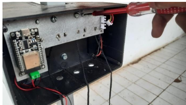
Gambar 4-15 Pemasangan Mikrokontroler ESP32 Kedalam Box
