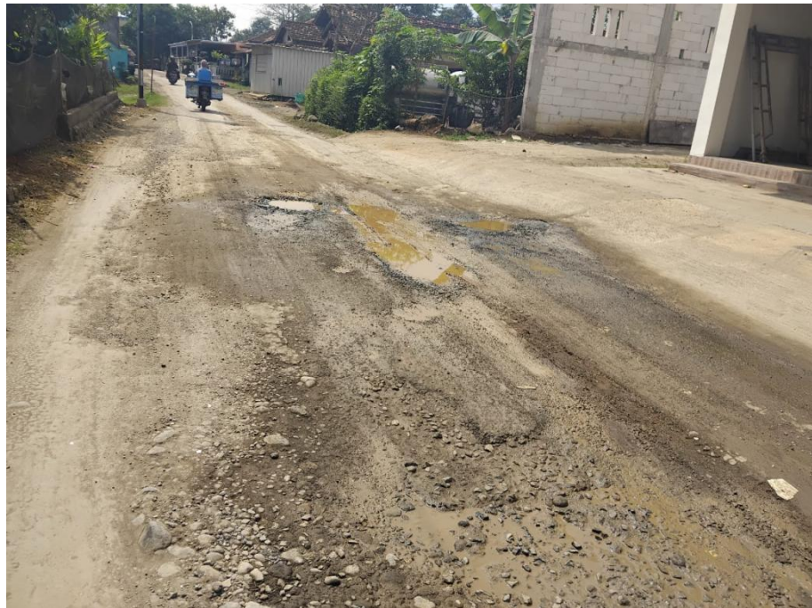
Gambar 4.25. Jalan yang perlu diperbaiki di Kecamatan Gembong
