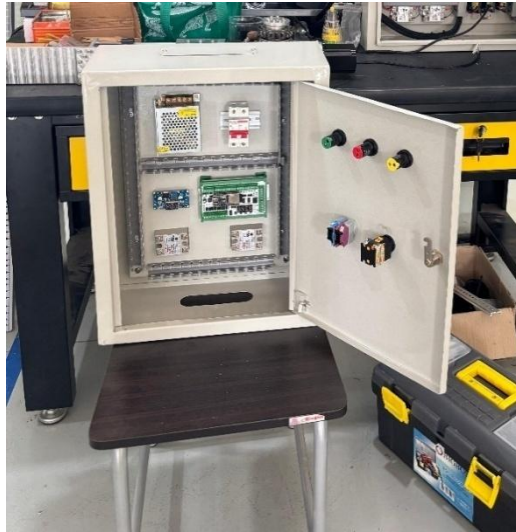
Gambar 4. 4 Komponen Yang Telah Terpasang Pada Box Panel
