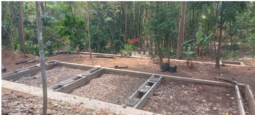
Gambar 3.11 Kolam IPAL TPA Tlekung
