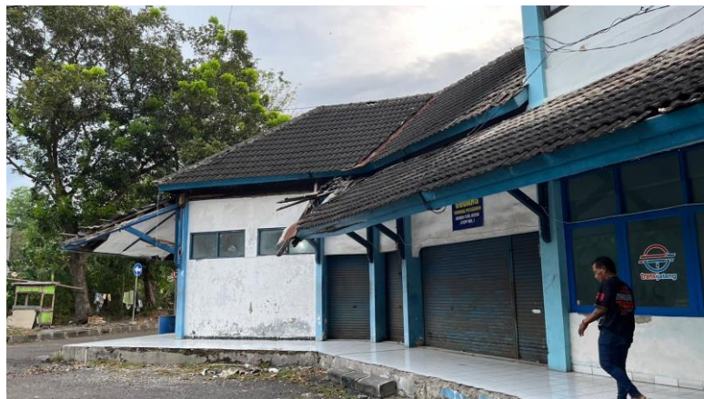
Gambar 37 Kondisi bangunan Terminal Penggaron
