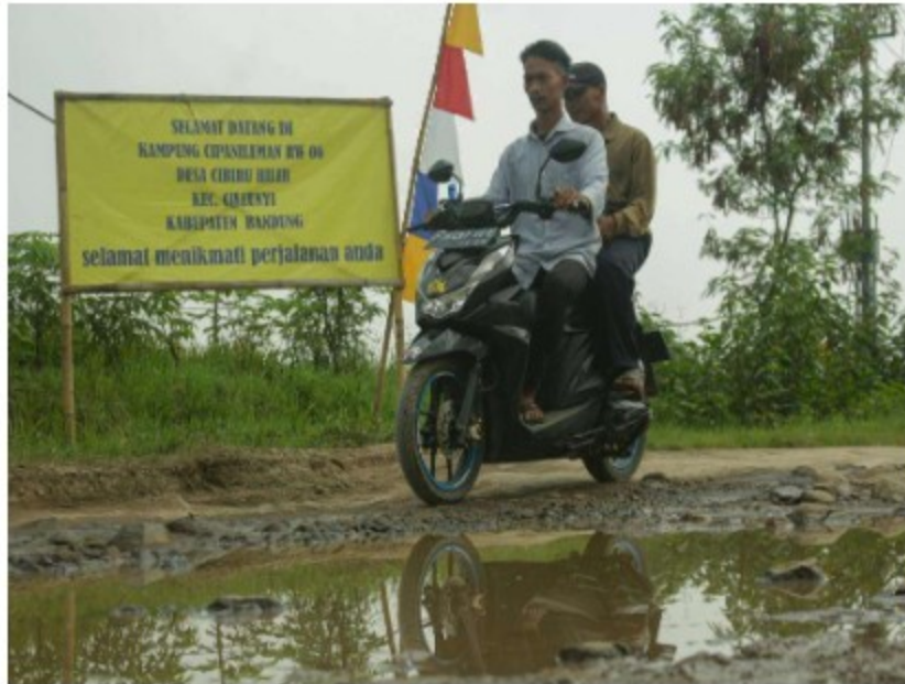
Gambar 2. 4 Jalanan Rusak di Sekitar Stasiun Tegalluar KCJB
