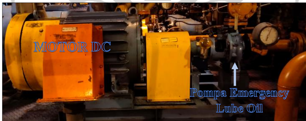
Gambar 2.5. Pompa Pelumasan Sumber: Dokumentasi Pribadi
