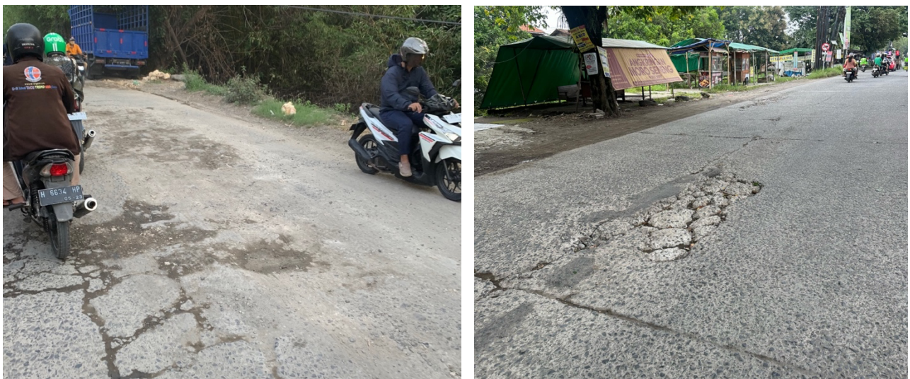
Gambar 1. 4 Akses jalan yang rusak
