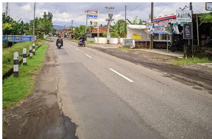
Gambar 1. 6 Kondisi Jalan Kabupaten, Purworejo
