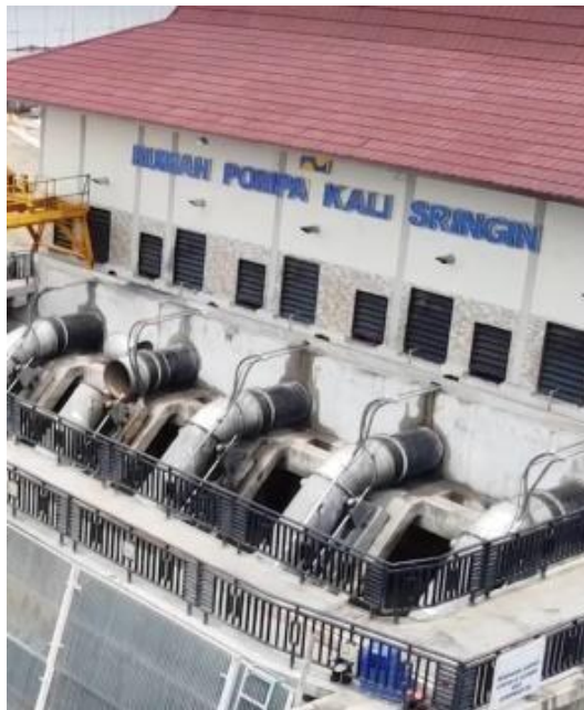
Gambar 3.4 Infrastruktur Rumah Pompa Sringin di Kota Semarang
