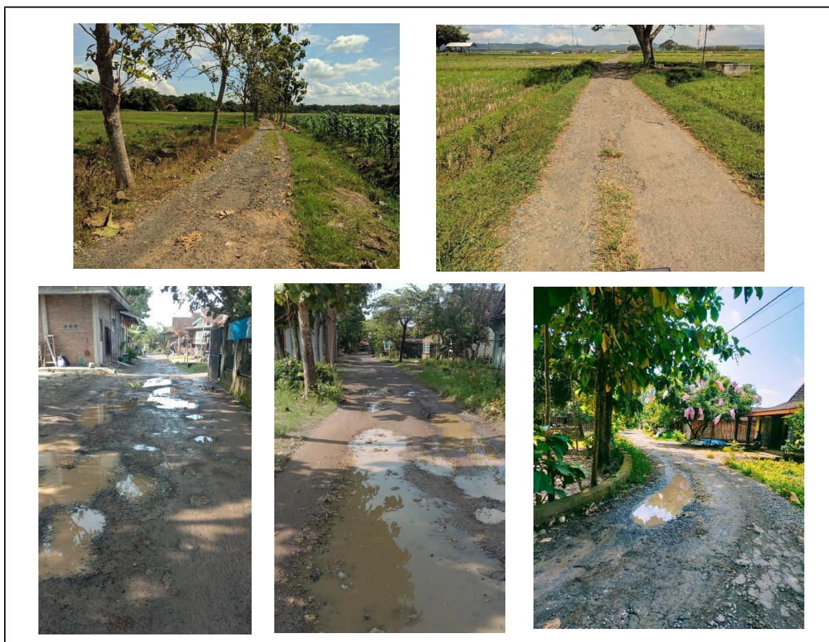
Gambar 2. Kondisi Infrastruktur Jalan di Desa Karangwotan
