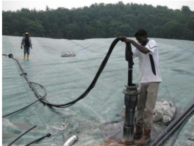
Gambar 2.28 Instalasi Pompa Lindi
