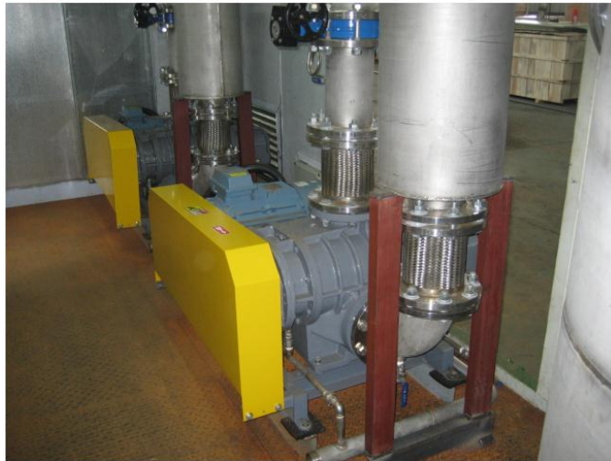
Gambar 2.32 Sistem Gas Blower
